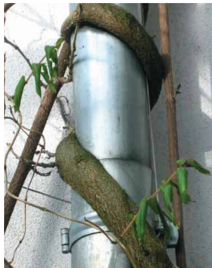
Häufiger Verwendungsfehler: Regenfallrohre sind denkbar ungünstige Schlinghilfen für Wisteria .
