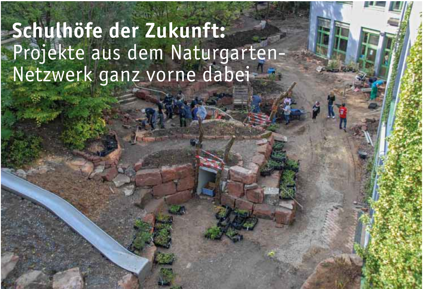
Impression aus der Baustelle in Neckargemünd: Jeder Zentimeter wurde zum Natur-Erlebnis-Schulhof umgestaltet
